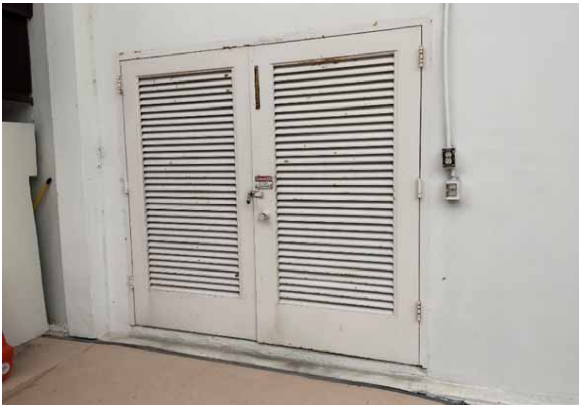
Doors - Bldg C FPL Vault
