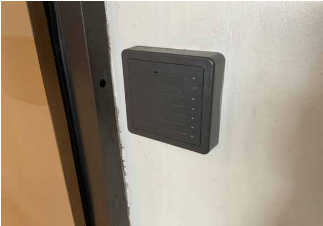
Bldg C FOB Reader
