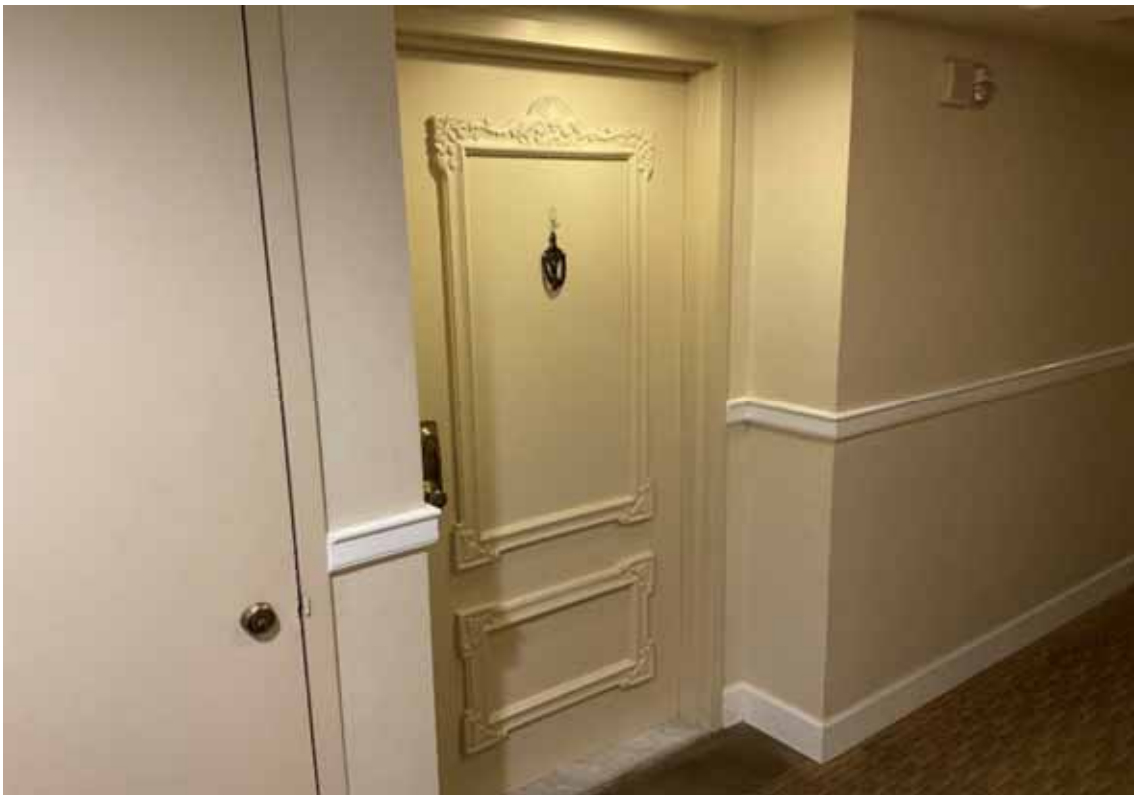
Bldg C Unit Door
