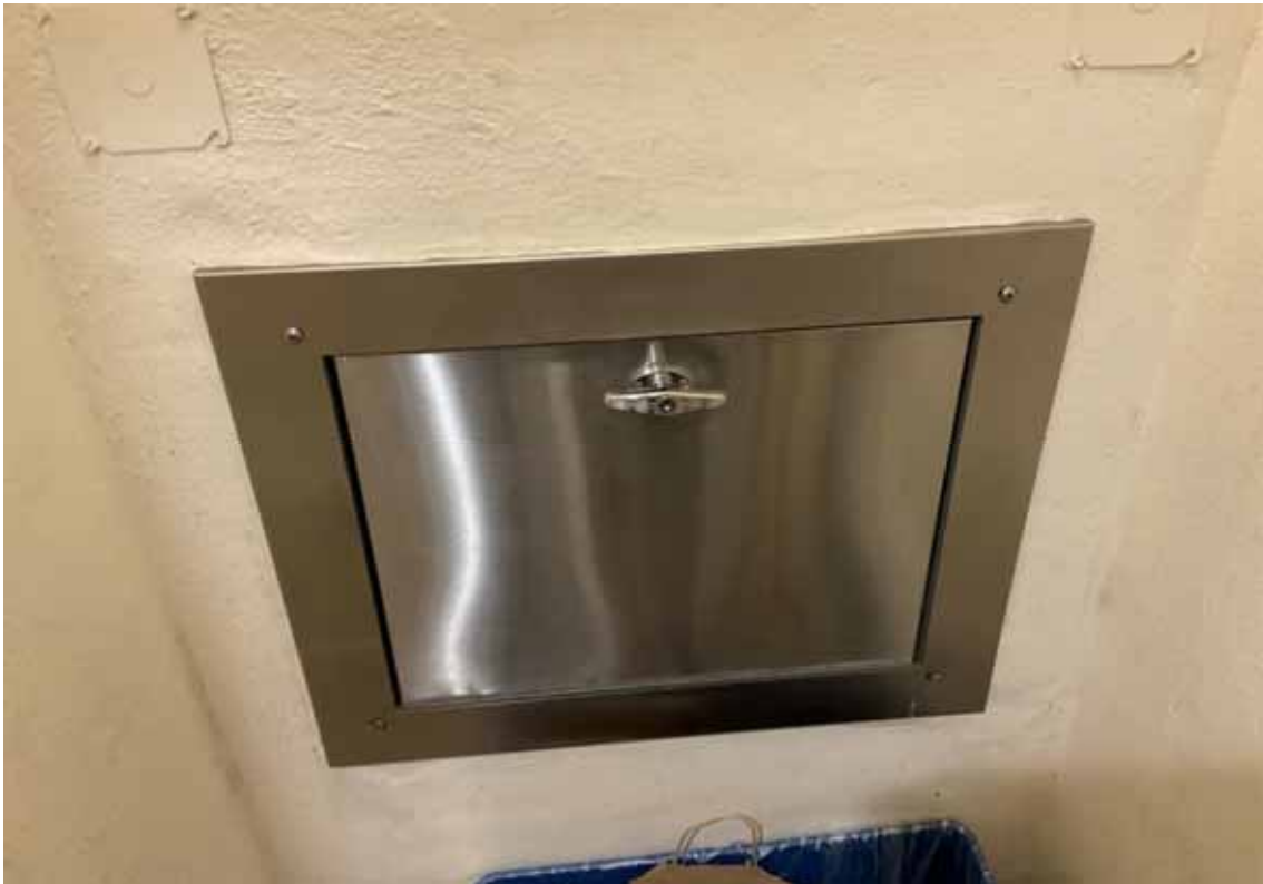
Bldg C Trash Chute Door
