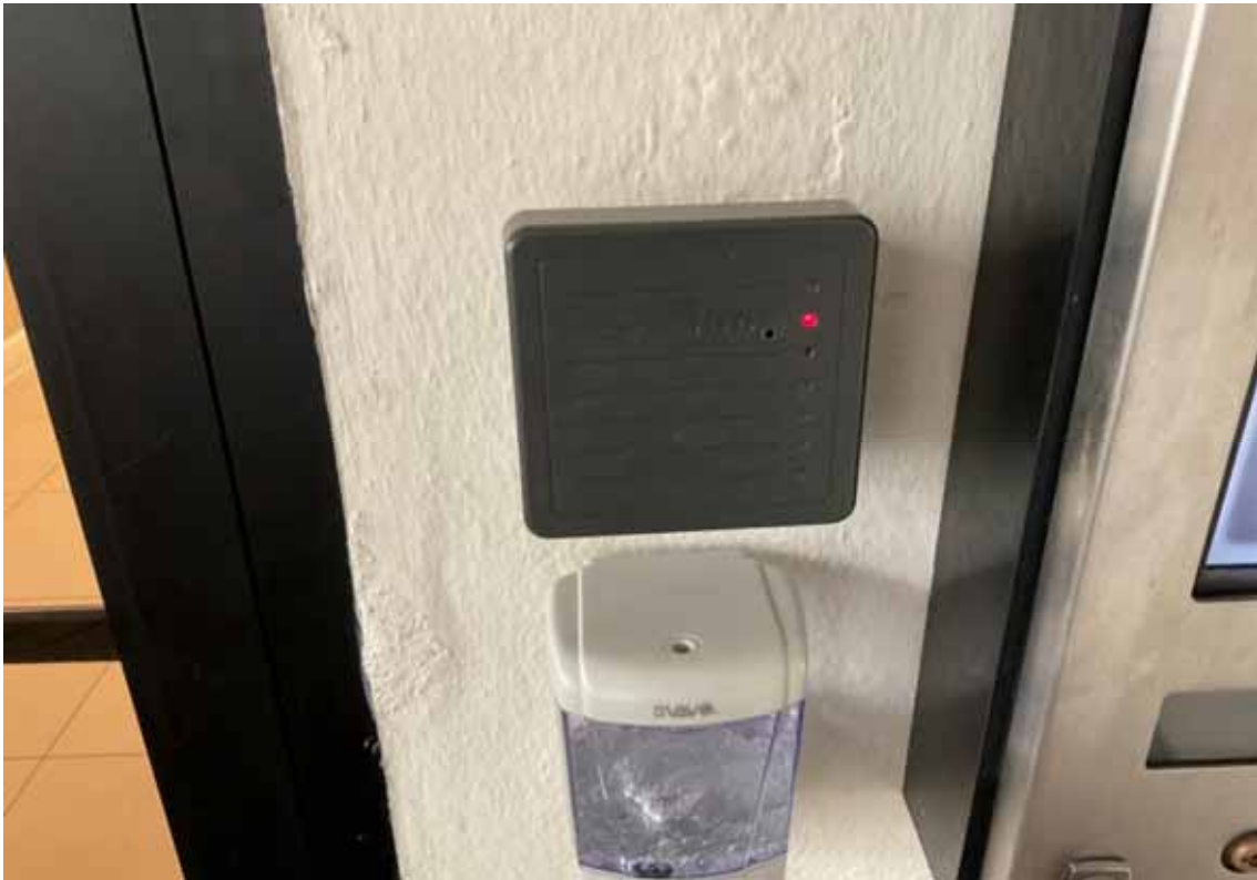
Bldg D FOB Reader
